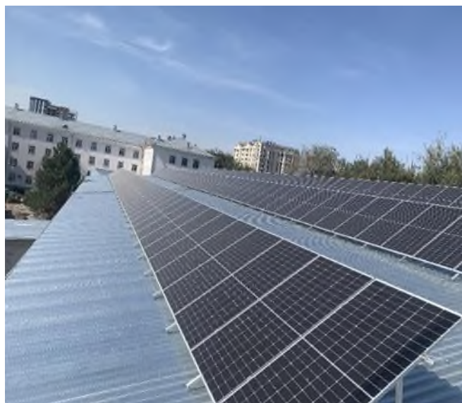
Рисунок 11 – Общий вид гелиополя СФЭС - 81,75 кВт.
