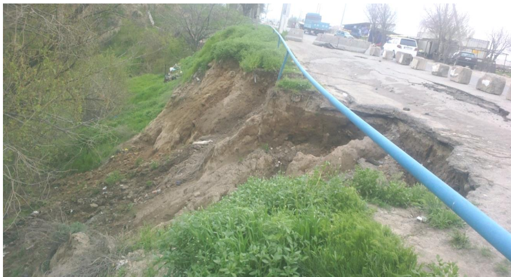
Рисунок 1 - Разрушение земляного полотна автомобильной дороги Ош - Сары-Таш - Иркештам
